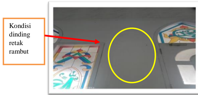
Gambar 3 : Kondisi dinding masjid Al-Falah
