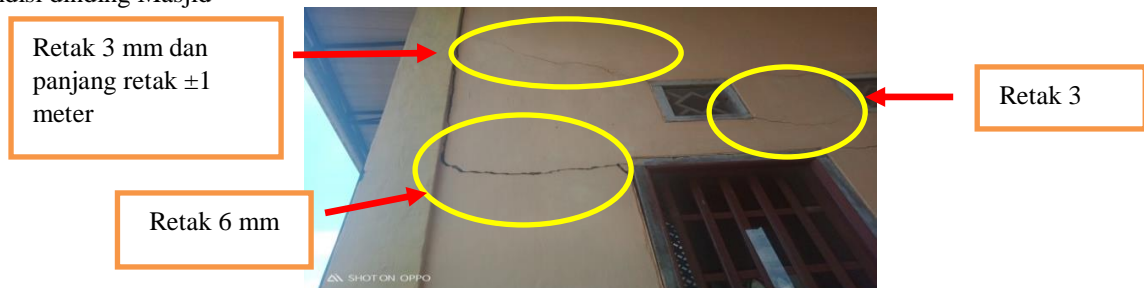
Gambar 4 : Kondisi dinding masjid AL-Ikhlas
