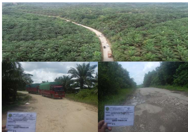
Gambar 1: Kondisi Ruas Jalan Semoi Sepaku Petung 1
