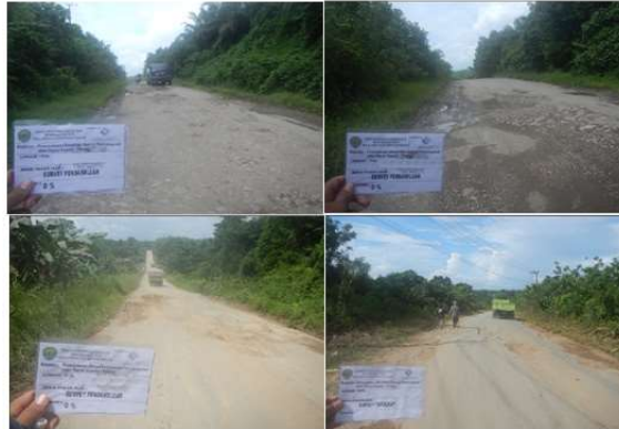
Gambar 4. Kondisi Ruas Jalan Semoi Sepaku - Petung 1
